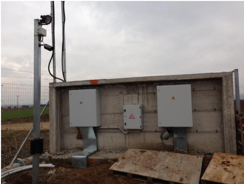
Εικ 3.2.3 Σύστημα περιμετρικής ανίχνευσης παραβίασης περίφραξης
