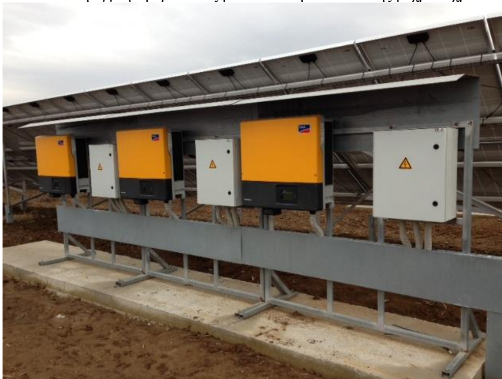
Εικ 3.2.10 Inverters στην πίσω όψη της συστοιχίας
