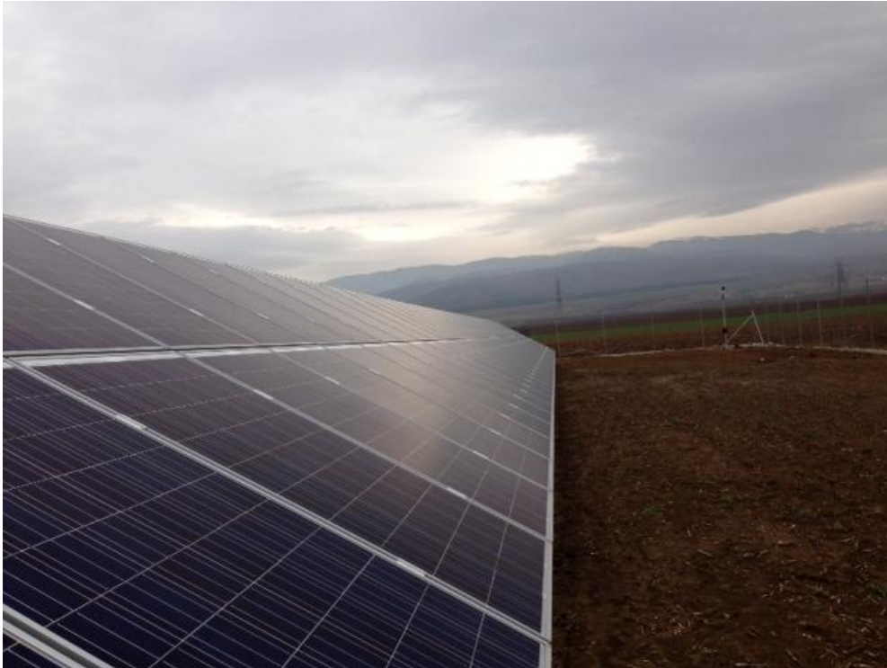
Εικ 3.2.9 Φ/Β συστοιγία της εγκατάστασης
