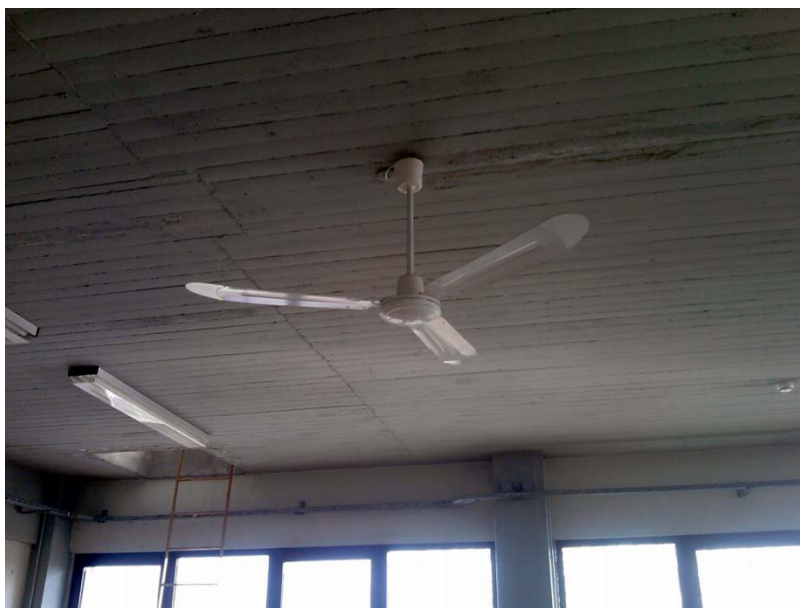
Εικόνα : Ανεμιστήρας Οροφής
