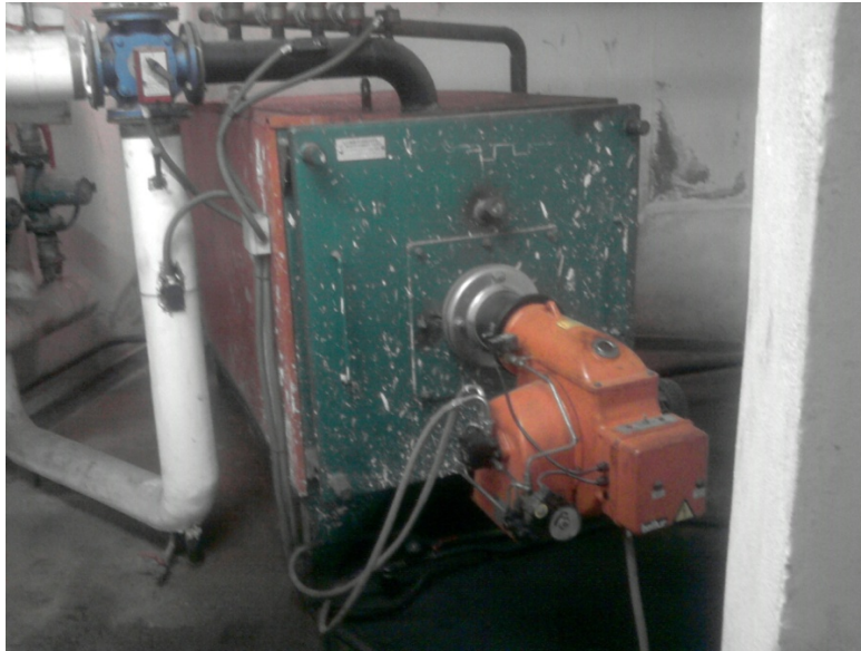
Εικόνα : Λέβητας με προσαρμοσμένο καυστήρα
