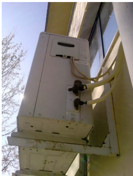
Εικόνα : Εξωτερική Κλιματιστική Μονάδα
