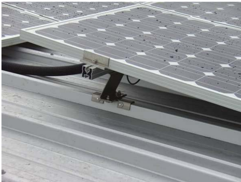
Σταθερές βάσεις σε οροφή κτιρίου
