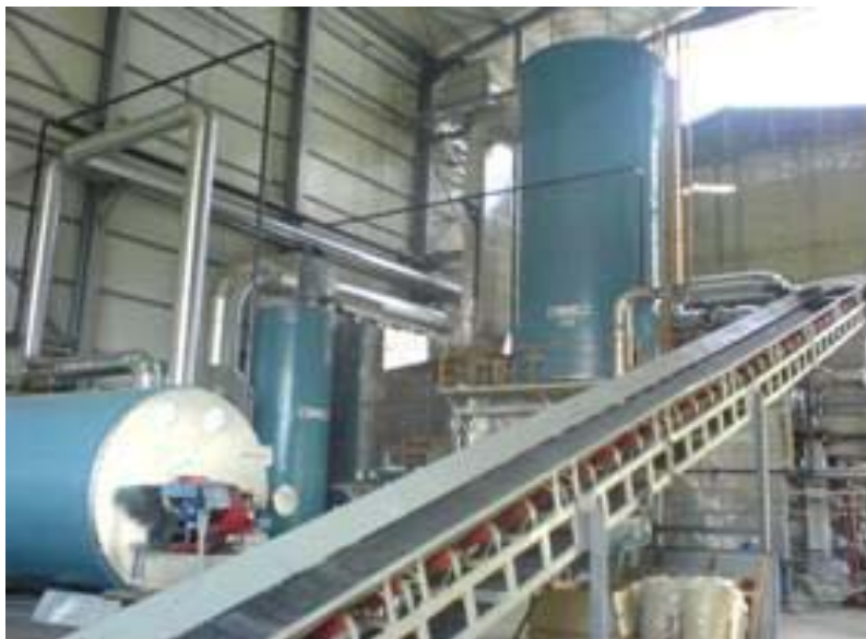
Εικόνα 4.18: ΛΕΒΗΤΑΣ ΔΙΑΘΕΡΜΙΚΟΥ ΕΛΑΙΟΥ 7,5 MW ΜΕ ΚΑΥΣΙΜΟ ΑΠΟΡΡΙΜΑΤΑ ΞΥΛΕΙΑΣ
