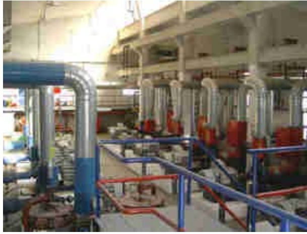
Εικόνα 14 : Αντλιοστάσιο Α3 Τηλεθέρμανσης Κοζάνης
