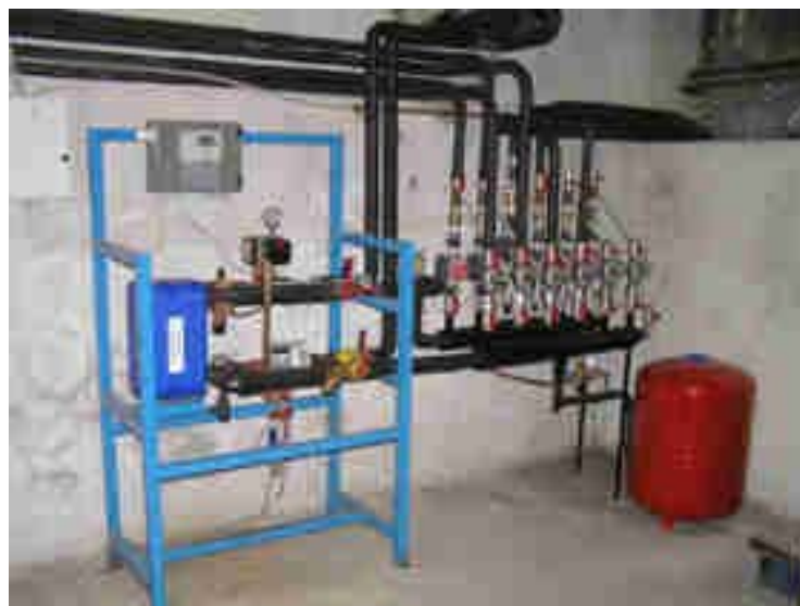
Εικόνα 16 : Τυπικές εγκαταστάσεις Θερμικών Υποσταθμών Καταναλωτών δικτύου ΤΗΛΕΘΕΡΜΑΝΣΗΣ ΑΜΥΝΤΑΙΟΥ
