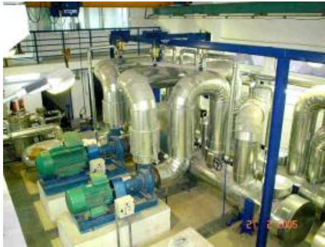
Εικόνα 15 : Αντλιοστάσιο Τηλεθέρμανσης ευρύτερης περιοχής Αμυνταίου
