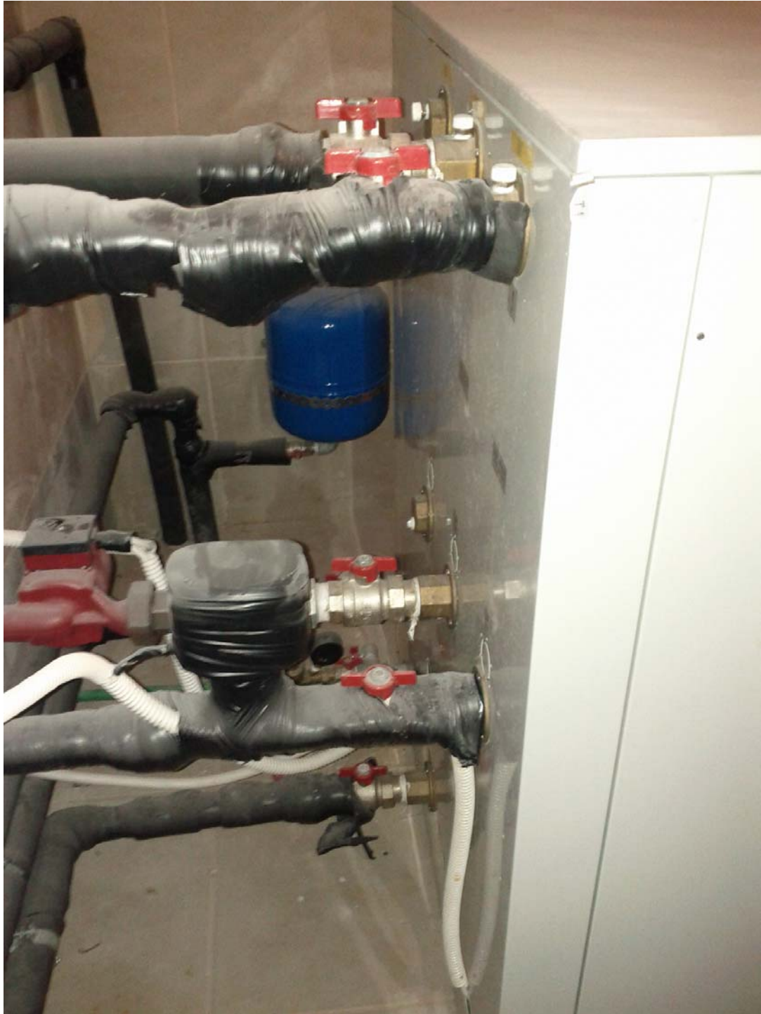
Εικόνα 36: Οι συνδέσεις των σωληνώσεων στο πίσω μέρος της αντλίας θερμότητας της εγκατάστασης ενδοδαπέδιας θέρμανσης με σύστημα γεωθερμικής αντλίας, της κατοικίας στα Μουδανιά Χαλκιδικής.
