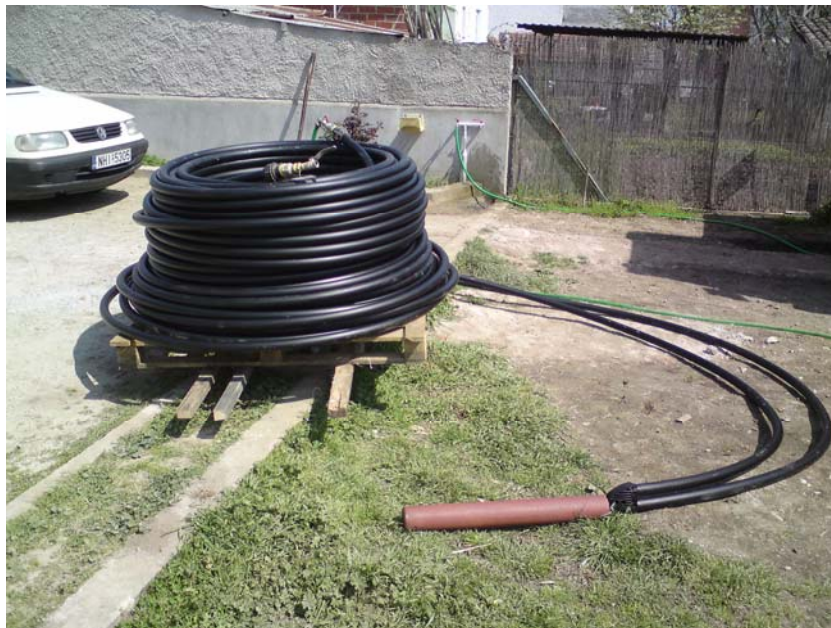
Εικόνα 20: Εξωτερικοί σωλήνες γεωεναλλάκτη από πολυαιθυλένιο κατά την εγκατάσταση γεωθερμικής αντλίας με κατακόρυφο γεωεναλλάκτη στην κατοικία των Μουδανιών της Χαλκιδικής.
