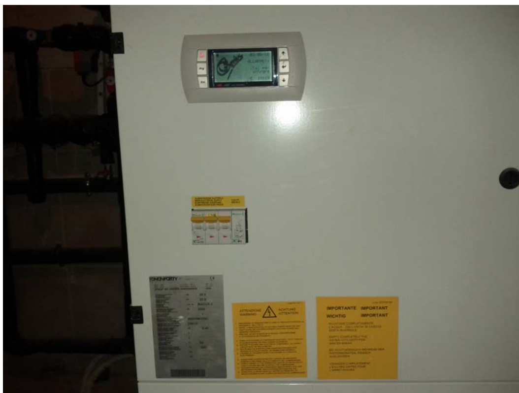
Εικόνα 37: Πίνακας ενδείξεων κατάστασης λειτουργίας της αντλίας θερμότητας, (κατοικίας στα Μουδανιά Χαλκιδικής).
