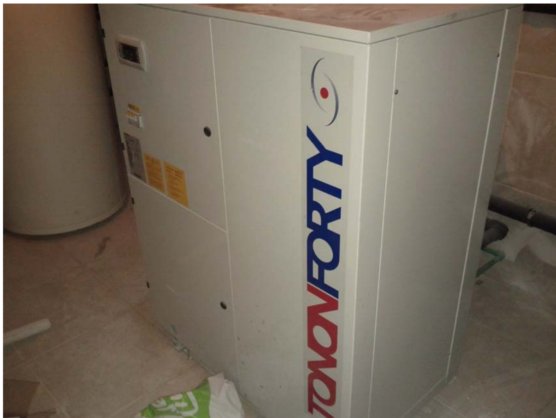
Εικόνα 35: Η αντλία θερμότητας της εγκατάστασης ενδοδαπέδιας θέρμανσης με σύστημα γεωθερμικής αντλίας, της κατοικίας στα Μουδανιά Χαλκιδικής.
