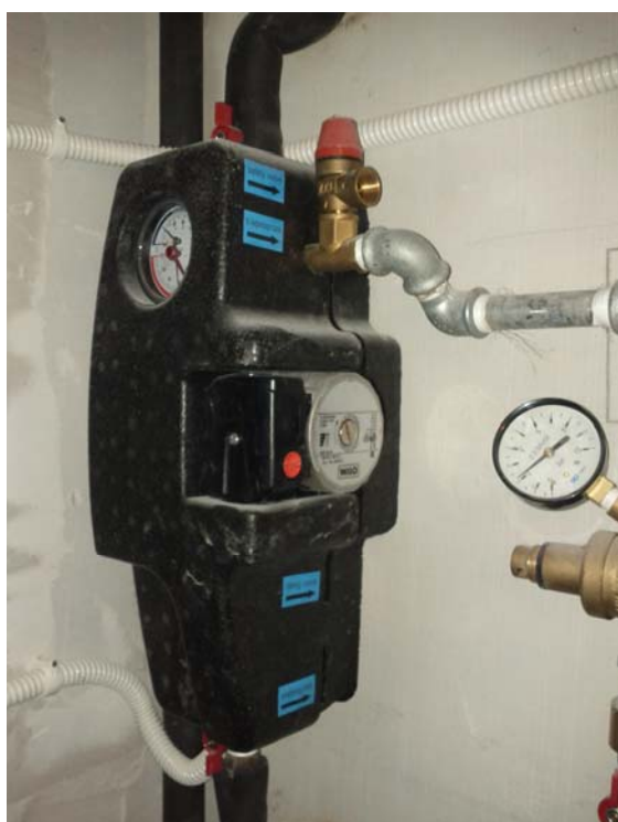
Εικόνα 39: Ο κυκλοφορητής μίξης του συστήματος ενδοδαπέδιας θέρμανσης με γεωθερμία της κατοικίας στα Μουδανιά Χαλκιδικής.
