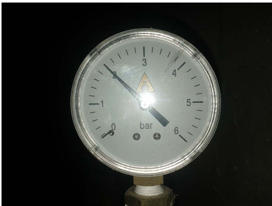
Εικόνα 38: Ένδειξη της πίεσης λειτουργίας της εγκατάστασης (κατοικίας στα Μουδανιά Χαλκιδικής).
