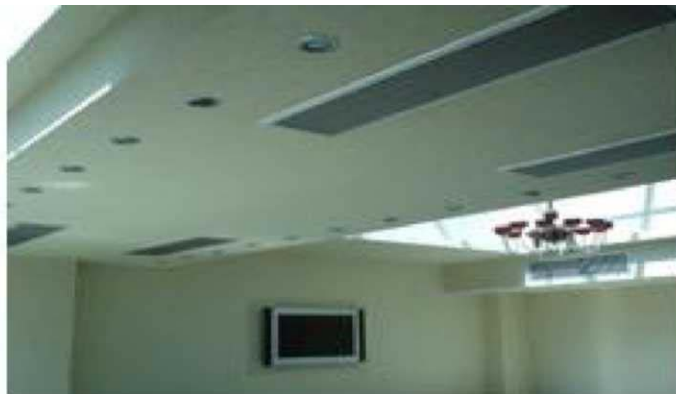
Fan coils ενσωματωμένα στην οροφή
