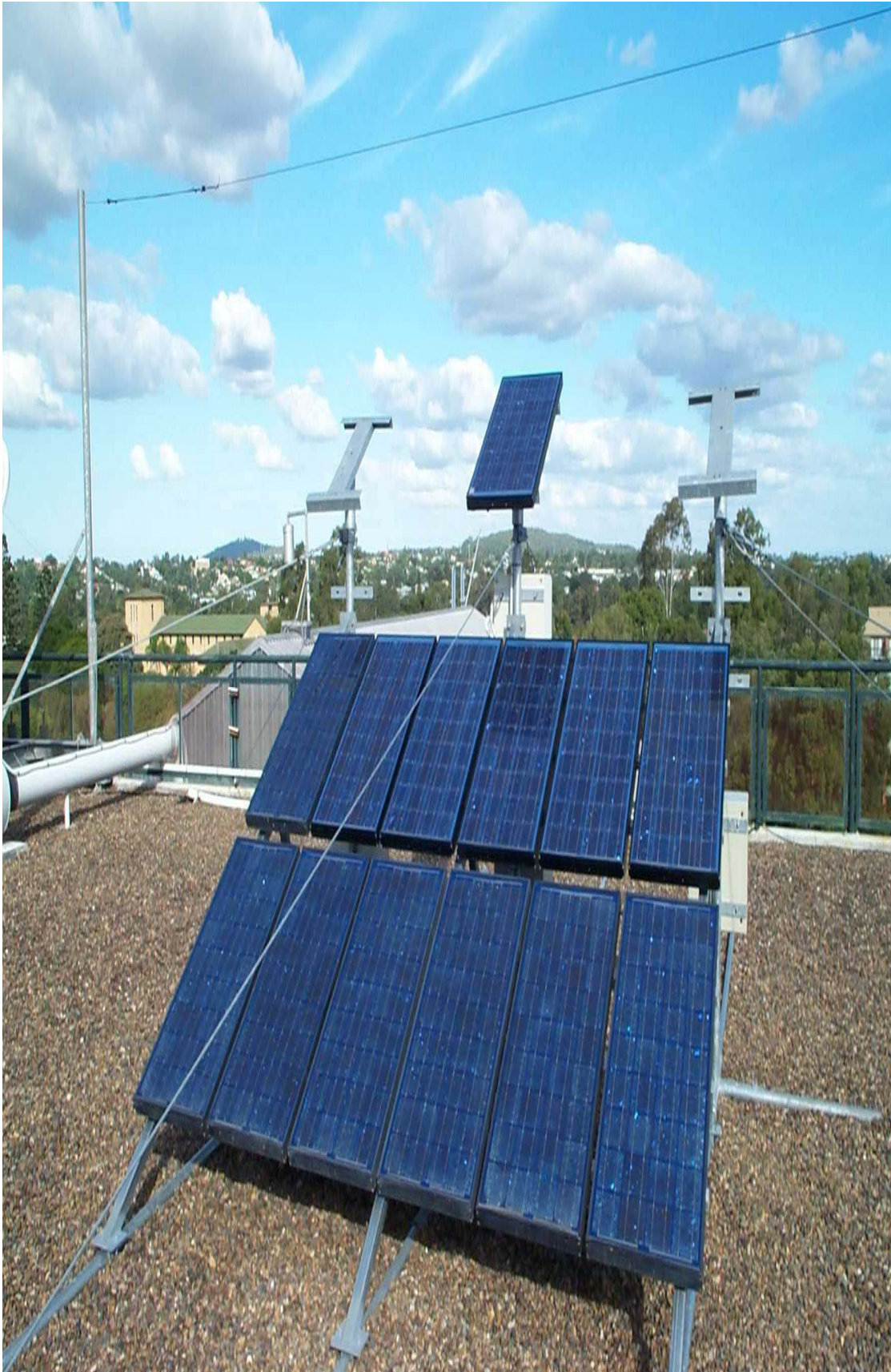
Εικόνα 21 : Ηλιακοί συλλέκτες σε ταράτσα εργοστασίου
