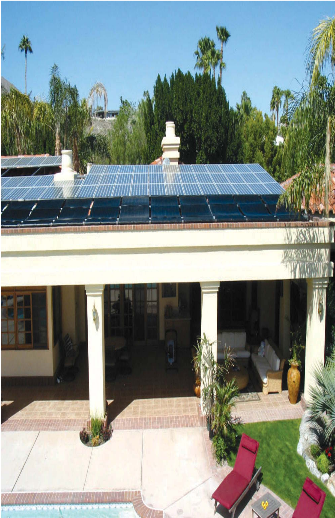
Εικόνα 15 : Ηλιακοί συλλέκτες τοποθετημένοι σε επίπεδη στέγη
