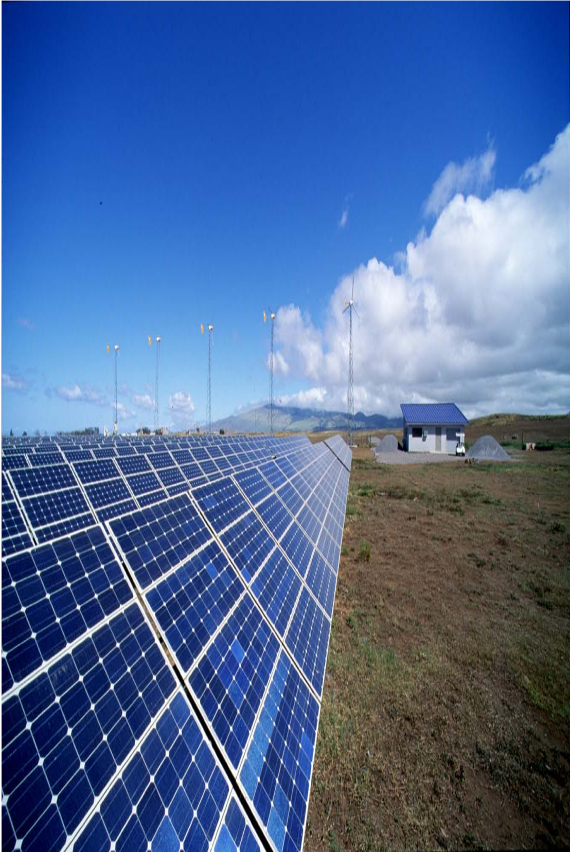
Εικόνα 18 - 19 : Συλλέκτες τοποθετημένοι στο έδαφος, σε εργοστάσιο παραγωγής ηλεκτρικής ενέργειας
