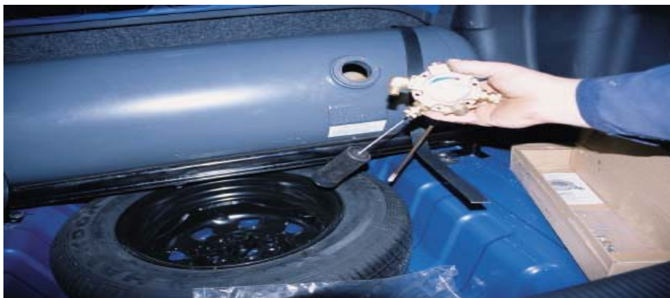
Εικόνα 3.2: Όργανα διακόπτες και βαλβίδες της δεξαμενής.
