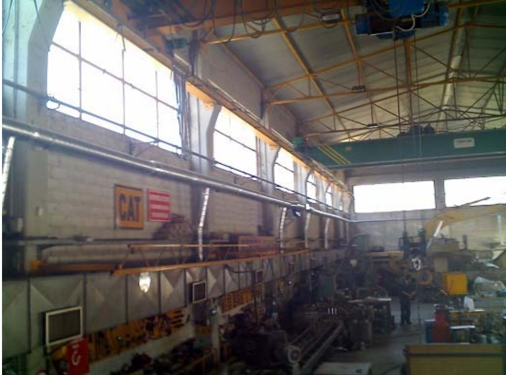
3.2 : Άποψη σύστημα επαγωγής καυσαερίων.
