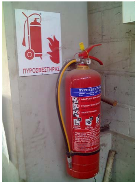
3.29 : Πυροσβεστήρας που πρέπει να υπάρχει στο χώρο του συνεργείου.
