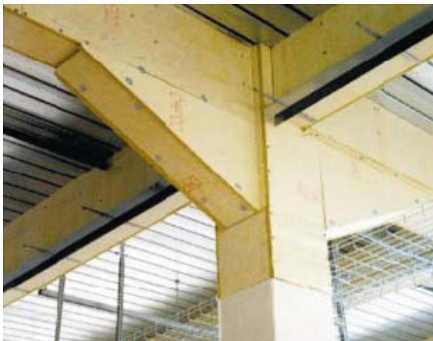
Σχήμα 3 Πυροπροστατευτικές πλάκες για την προστασία κόμβου μεταλλικών στοιχείων
