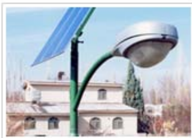
Αυτόνομο φωτιστικό οδού
