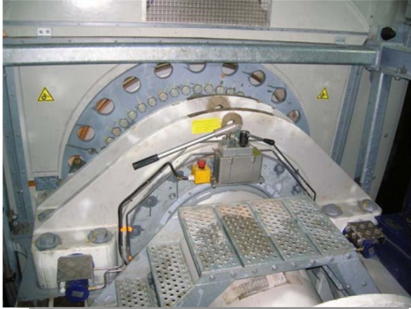
Έδραση άξονα χαμηλής ταχύτητας στην πλευρά του ρότορα
