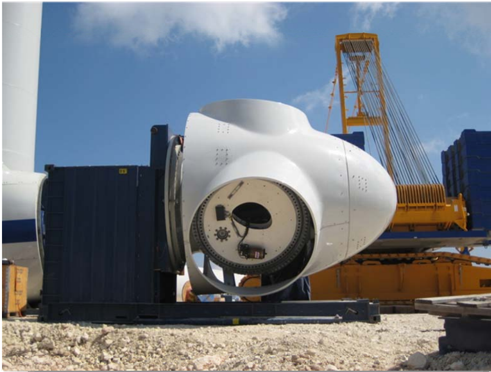
Ρότορας (δρομέας) ανεμογεννήτριας.
