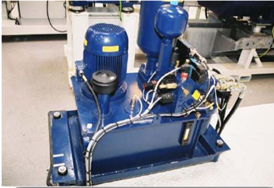
Μονάδα ισχύος υδραυλικού συστήματος
