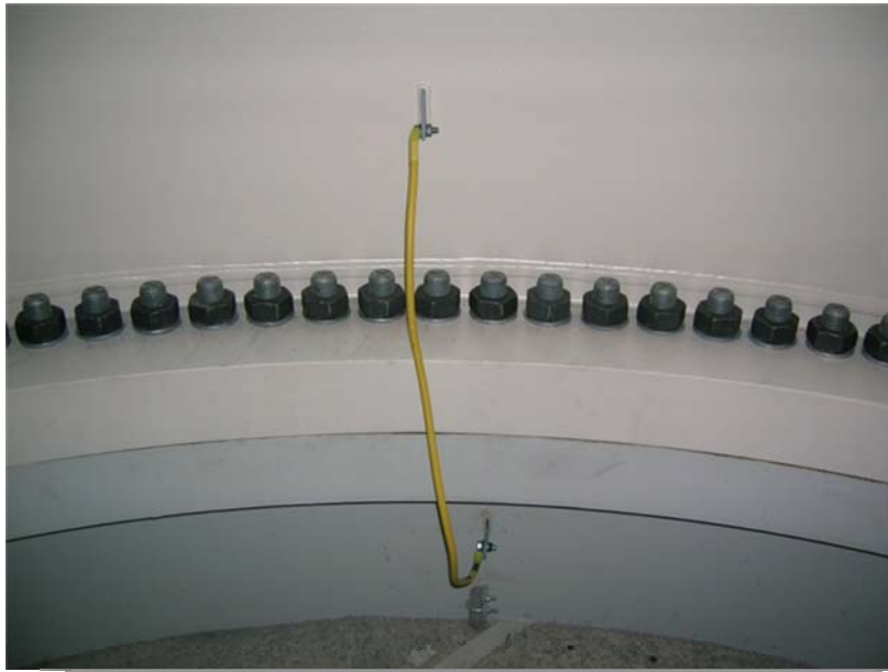
Γείωση μεταξύ τμημάτων του πύργου
