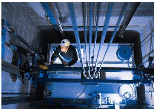
Εικόνα 1.8 Συρματόσχοινα ανύψωσης ανελκυστήρα
