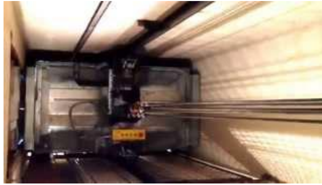
Εικόνα 1.2 Φρεάτιο κίνησης ανελκυστήρα
