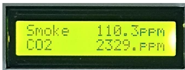
Σχήμα 38: Ένδειξη καπνού και διοξειδίου του άνθρακα
