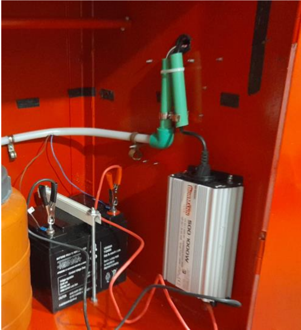
Εικόνα 25: Τοποθετημένα και συνδεμένα Μπαταρία και Αναστροφέας (inverter).
