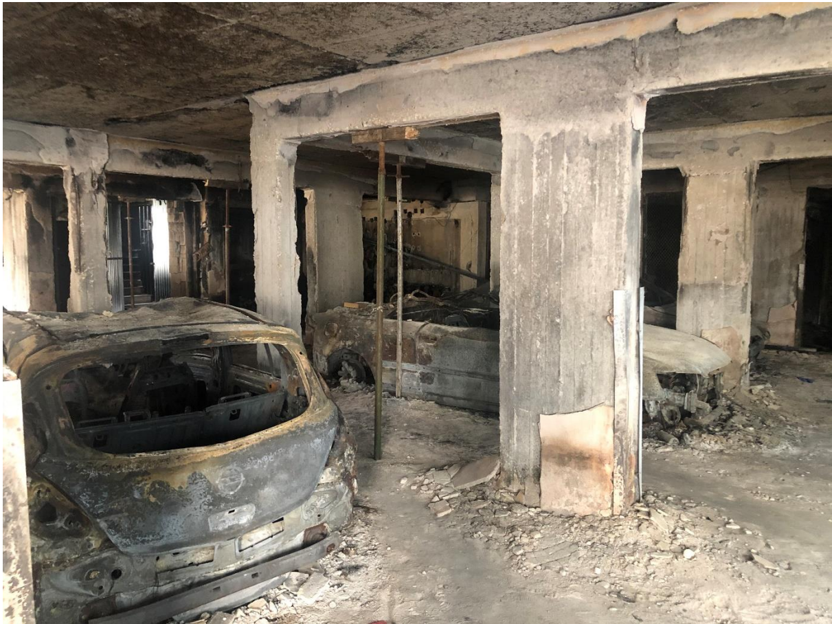
Εικόνα 5: Κατάσταση πυλωτής έπειτα από την πυρκαγιά
