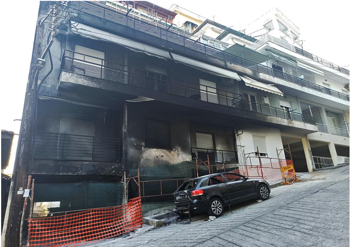
Εικόνα 3: Όψη κτιρίου έπειτα από την πυρκαγιά
