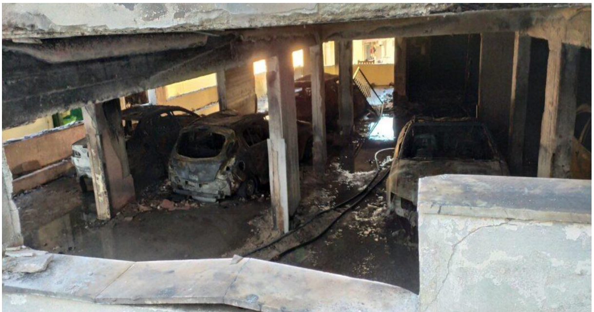
Εικόνα 4: Πυλωτή κτιρίου έπειτα από την πυρκαγιά
