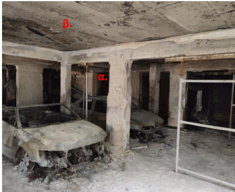
Εικόνα 6: α. Εκτίναξη επικάλυψης οπλισμών – β. Θερμομονωτικές πλάκες, ίδια επεξεργασία
