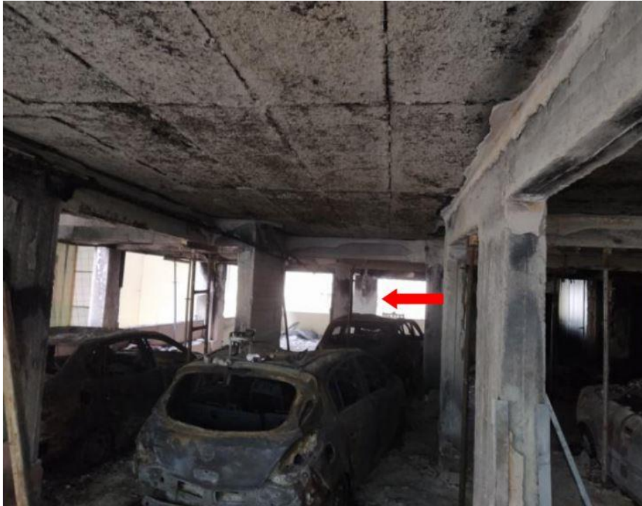
Εικόνα 8: Στο βάθος φαίνεται το υποστύλωμα K37 το οποίο διατήρησε το επίχρισμα του και είναι μόνο καπνισμένο στο ανώτερο τμήμα του, πηγή: ίδια επεξεργασία
