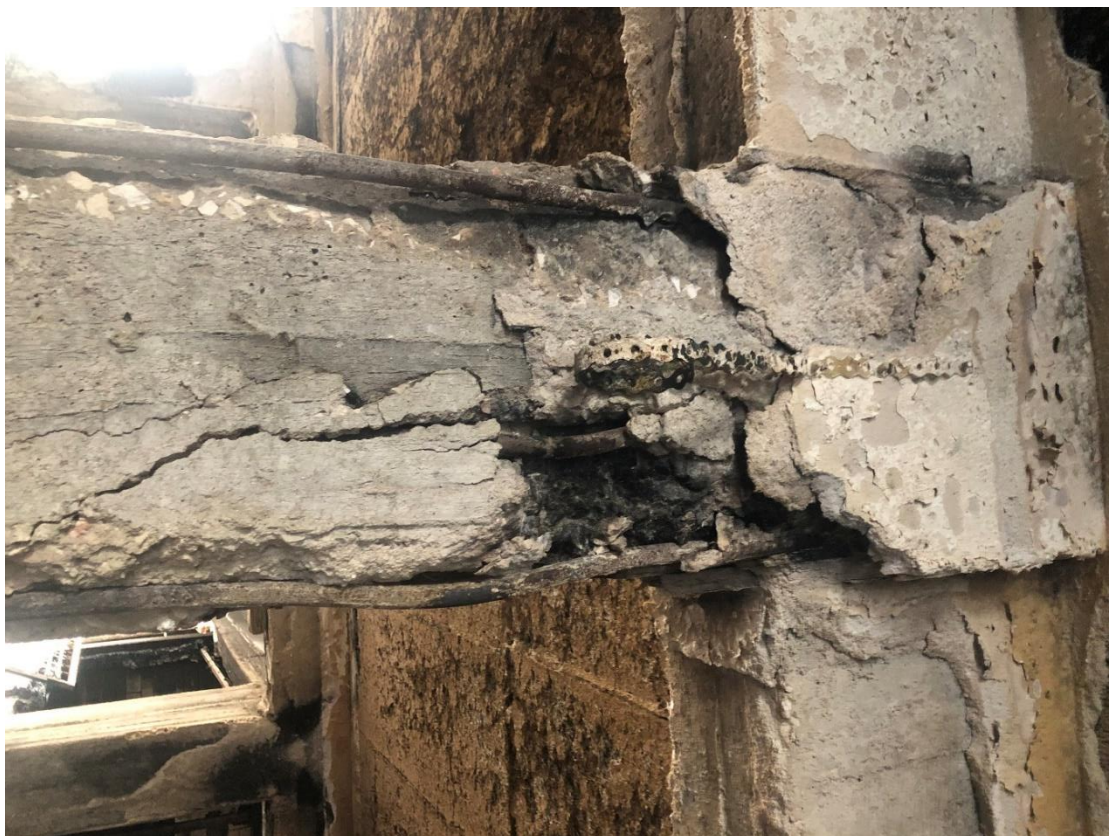
Εικόνα 7. Κατάσταση υποστυλώματος (οπλισμός και αποφλοίωση σκυροδέματος)
