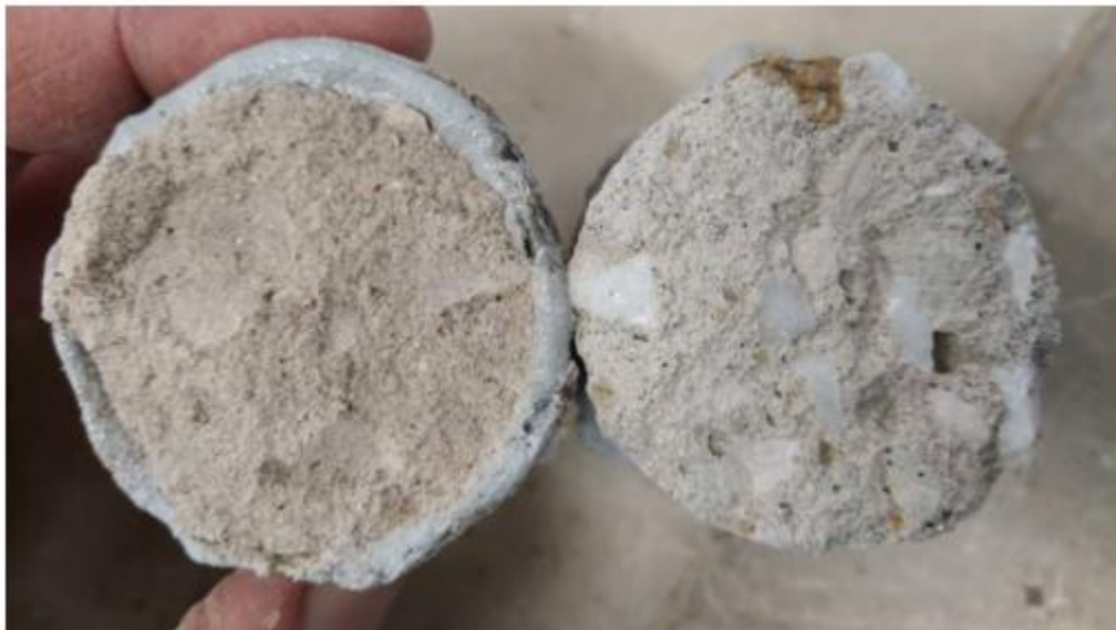
Εικόνα 4.15. Σύγκριση των T1 και K38 που βρίσκονται σε προβεβλημένη και υγιή περιοχή αντίστοιχα. Στο πρώτο η αστοχία συνέβη σε βάθος μόλις 0,3 cm και τάση 0,05 MPa με εμφανή τα σημεία αποκόλλησης των αδρανών. Στο K38 η θραύση συνέβη στο μέγιστο βάθος των 3 cm με τάση 1,78 MPa , σημαντικά υψηλότερη καθώς παρατηρούνται θραυσμένα αδρανή τα οποία συμμετείχαν στον μηχανισμό παραλαβής δυνάμεων
