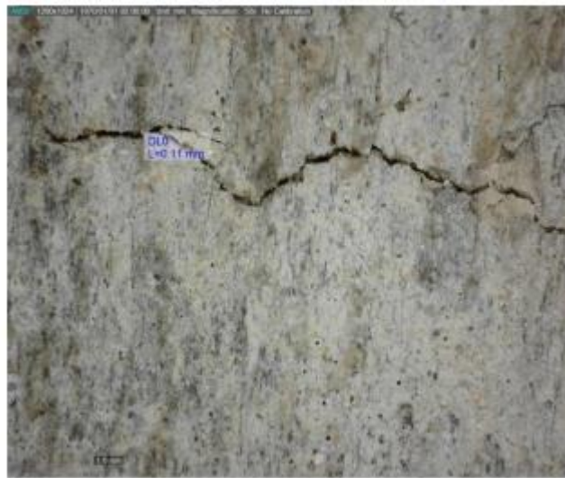
Εικόνα 4.6 Δείγμα σκυροδέματος από περιοχή που εκτέθηκε σε φωτιά
