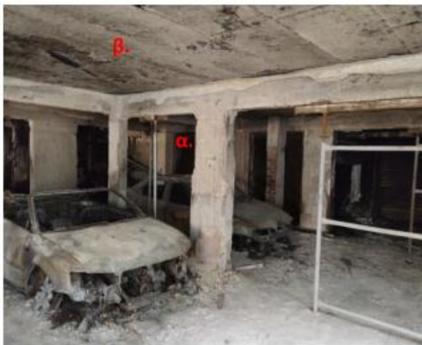
Εικόνα 4.1 α. Εκτίναξη της επικάλυψης οπλισμών, β. Θερμομονωτικές πλάκες
