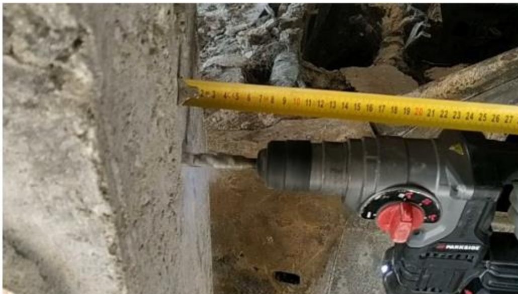
Εικόνα 4.16. Δοκιμή αντίστασης σε διείσδυση του σκυροδέματος κατά τη διάτρηση με κρουστικό δράπανο
