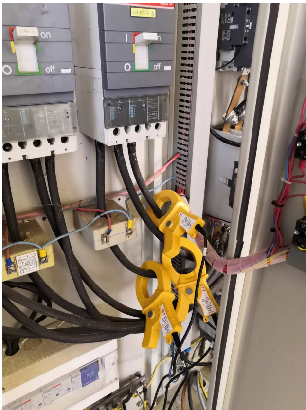
Figure 12: Θέση μετασχηματιστών έντασης.
