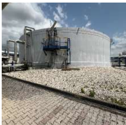
Εικόνα 598 Δεξαμενή Πυρόσβεσης ΜΣΣ Σιδηροκάστρου
