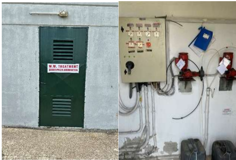
Εικόνα587. Σύστημα Βιολογικού Καθαρισμού ΜΣΣ Σιδηροκάστρου
