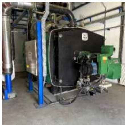
Εικόνα 543 Λέβητες ΦΑ ΜΣΣ Σιδηροκάστρου
