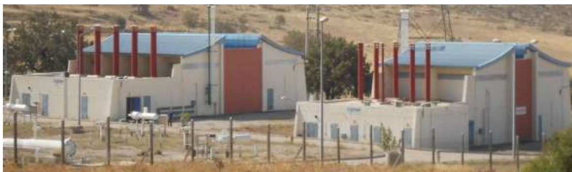
Εικόνα35.Τυπική εγκατάσταση MR
