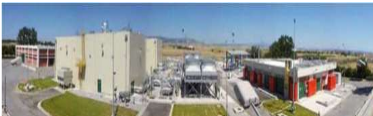
Εικόνα 133. Ο Σταθμός Συμπίεσης της Νέας Μεσημβρίας
