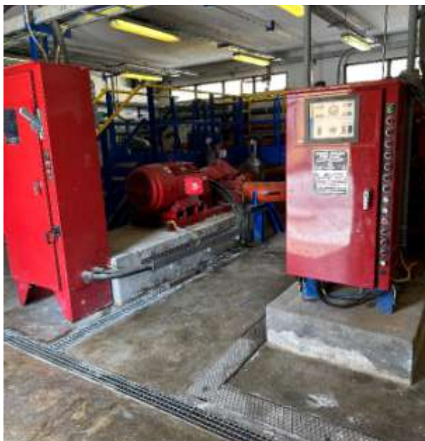
Εικόνα 521. Αντλίες Πυρόσβεσης ΜΣΣ Σιδηροκάστρου
