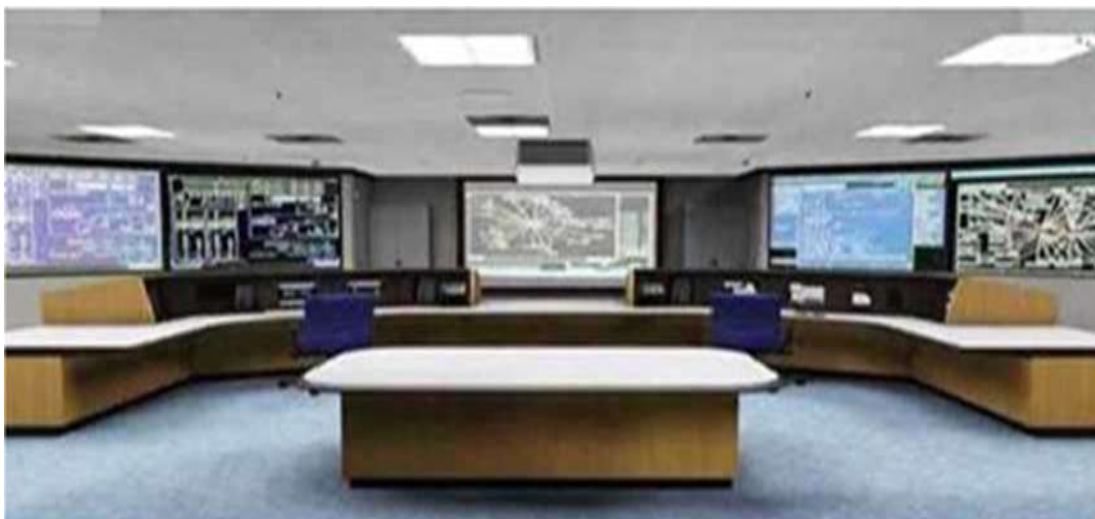
Εικόνα 144. Κέντρο Ελέγχου και Κατανομής Φορτίου
