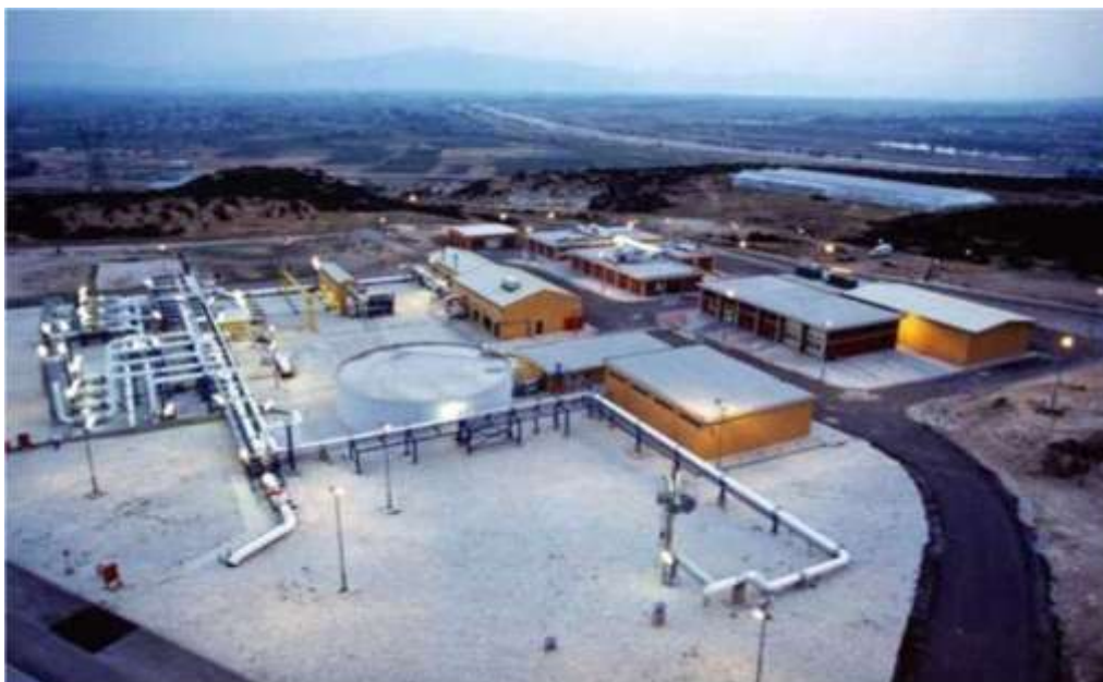
Εικόνα 122. Μετρητικός Σταθμός Συνόρων Σιδηροκάστρου [8ε]
