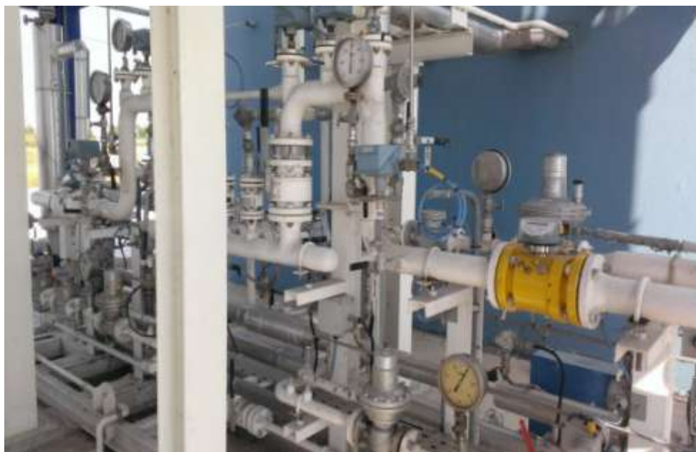
Εικόνα 46. Εγκατάσταση τροφοδοσίας καυσίμου αερίου σε βοηθητικές εγκαταστάσεις
