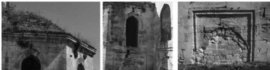
Εικ. 4: α. Λεπτομέρεια της κόγχης του μιχράμπ, β. ρωγμές σε άνοιγμα της όψης, γ. κλειστό άνοιγμα με σύγχρονα υλικά.
