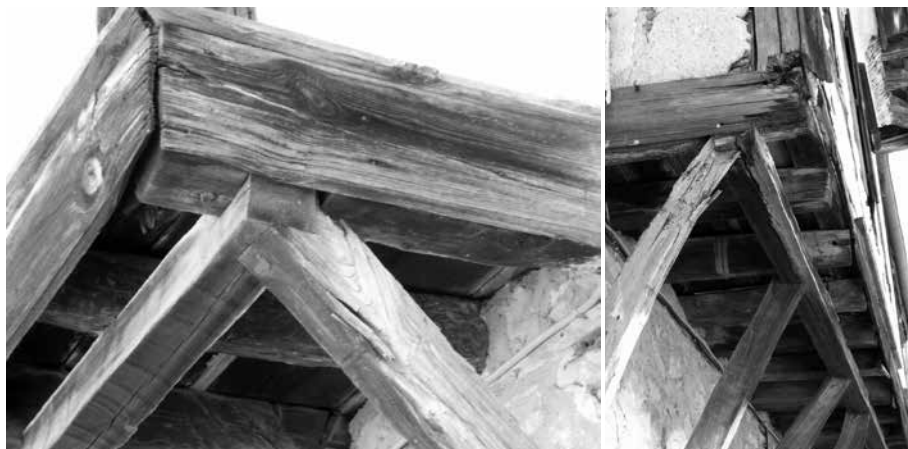
Εικ. 13: Λεπτομέρειες σύνδεσης αντιρίδας με εντορμία, σε ιστορική κατοικία του Ροδολίβου (Α.Μ.967).
