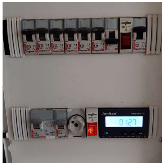
Εικόνα 46 Σύνδεση του Janitza D21 στον ηλεκτρολογικό πίνακα
