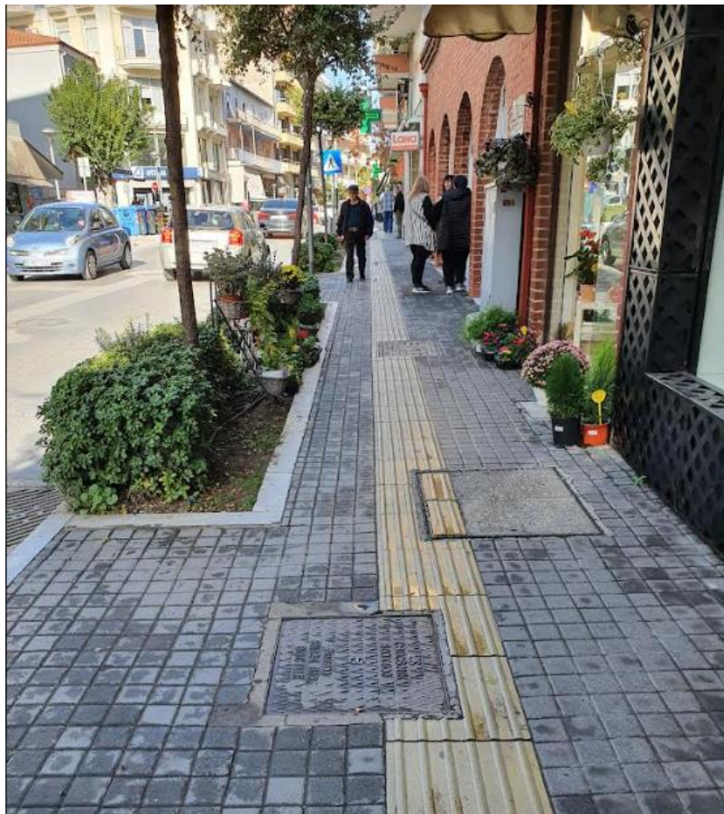
Εικόνα 30 Παρά την ύπαρξη πλακών όδευσης τυφλών, το πεζοδρόμιο εκλεπτύνεται λόγω θάμνων, ενώ επί του ενός φρεατίου δεν έχει τοποθετηθεί συνέχεια όδευσης τυφλών όπως προβλέπεται.
