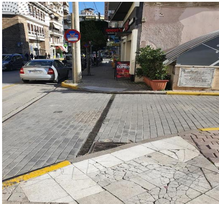
Εικόνα 24 Πεζοδρόμια περίξ του Δημαρχείου επί της Μητροπόλεως. Η κατάσταση του πλακόστρωτου απαγορεύει την κίνηση αναπηρικών αμαξιδίων επί αυτού.
