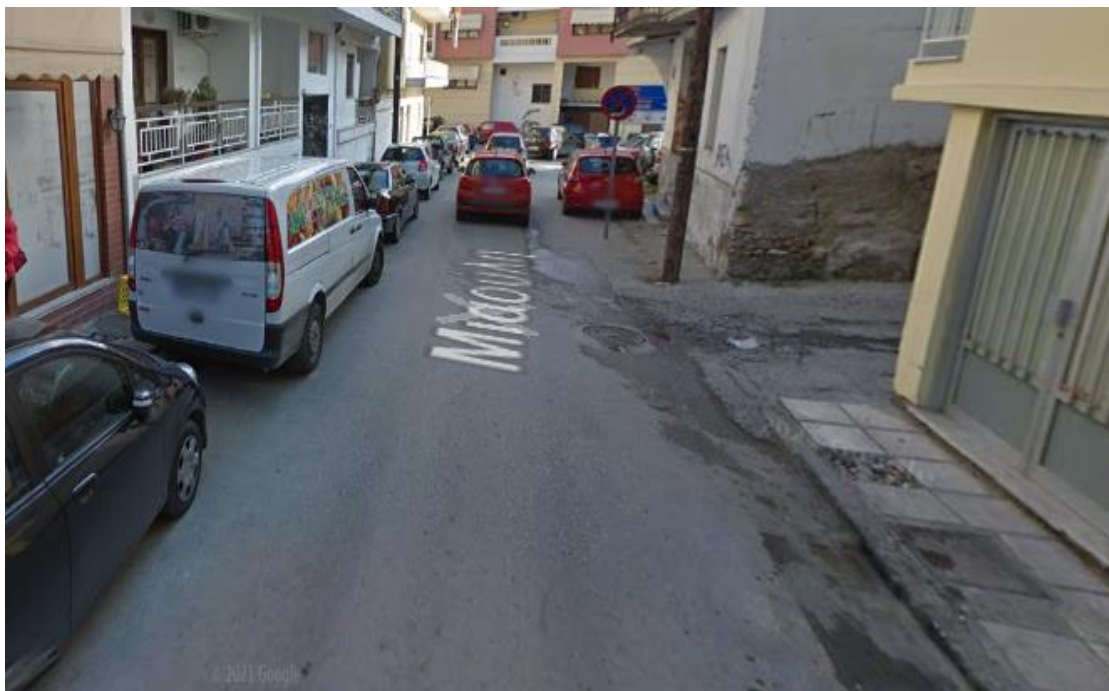
Εικόνα 43 Αποκόλληση πλακών και στενότητα πεζοδρομίου που αποτρέπει πλήρως την κινητικότητα των εμποδιζόμενων ατόμων
