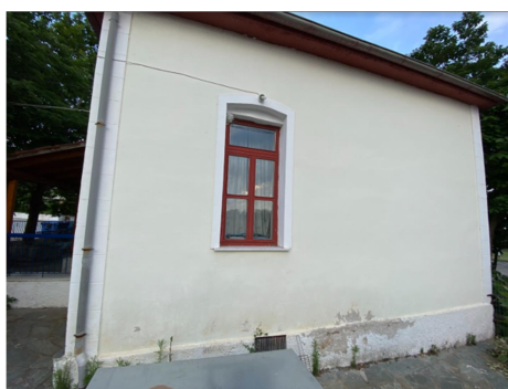
Εικόνα 4.175 Δ πλάγια όψη (Πηγή: Τ.Υ.)
