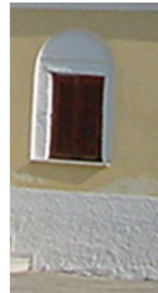
Εικόνα 4.140 Παράθυρο ισογείου (Πηγή: Τ.Υ.)
