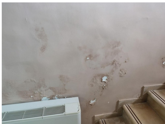
Εικόνα 4.263 Αποφλοιώσεις επιχρισμάτων ημιυπογείου (Πηγή: Ζ.Κ.)
