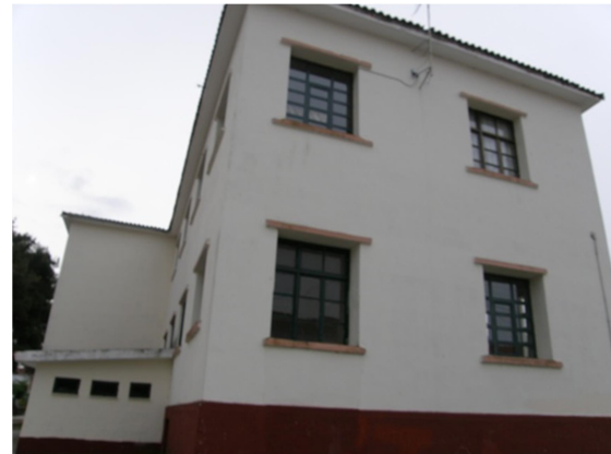
Εικόνα 4.203 Δ πλάγια όψη (Πηγή: Τ.Υ.)
