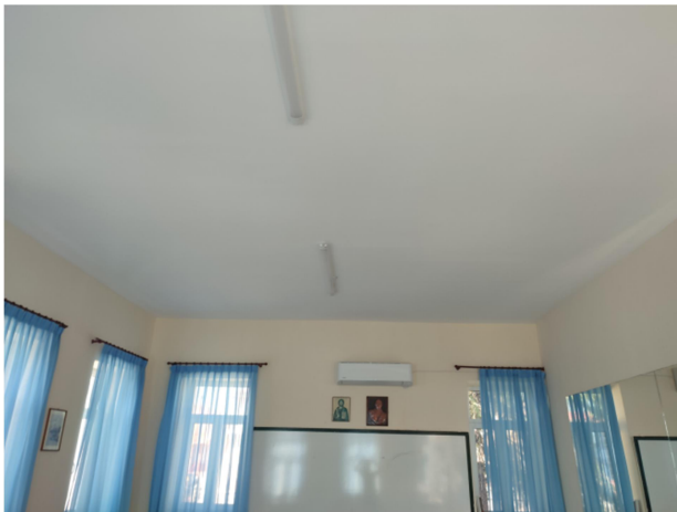
Εικόνα 4.309 Ψευδοροφή (Πηγή: Ζ.Κ.)
