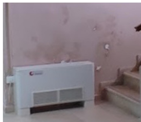
Εικόνα 4.264 Αποφλοιώσεις επιχρισμάτων ημιυπογείου (Πηγή: Ζ.Κ.)
