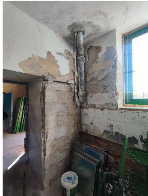
Εικόνα 4.278 Ανεπίχριστη εσωτερική τοιχοποιία υπογείου (Πηγή: Ζ.Κ.)
