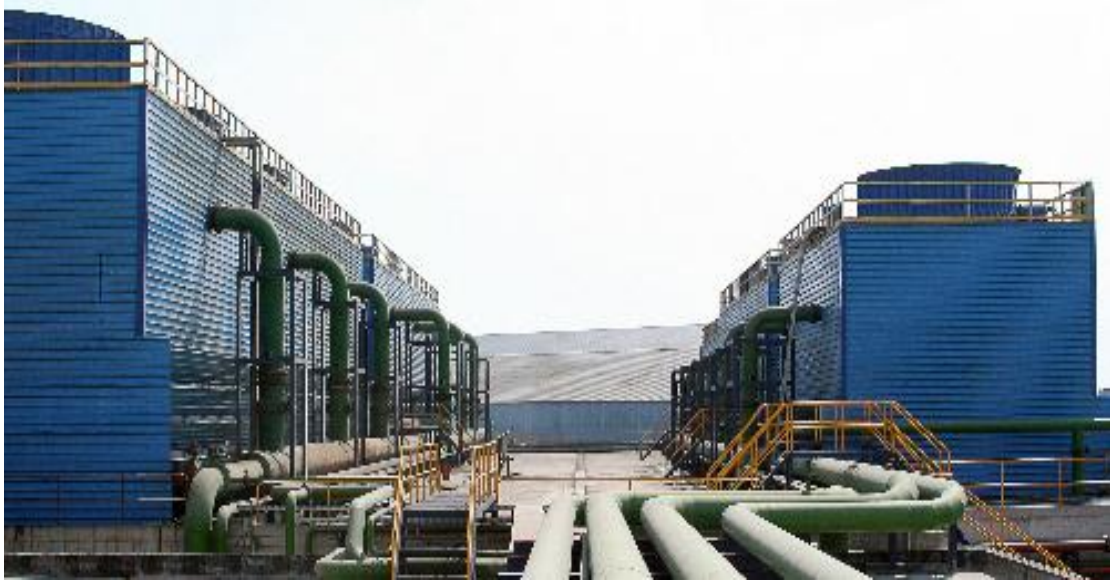
Εικόνα 37: Πύργος ψύξης νερού (με το χαρακτηριστικό πράσινο χρώμα στο δίκτυο σωληνώσεων)
