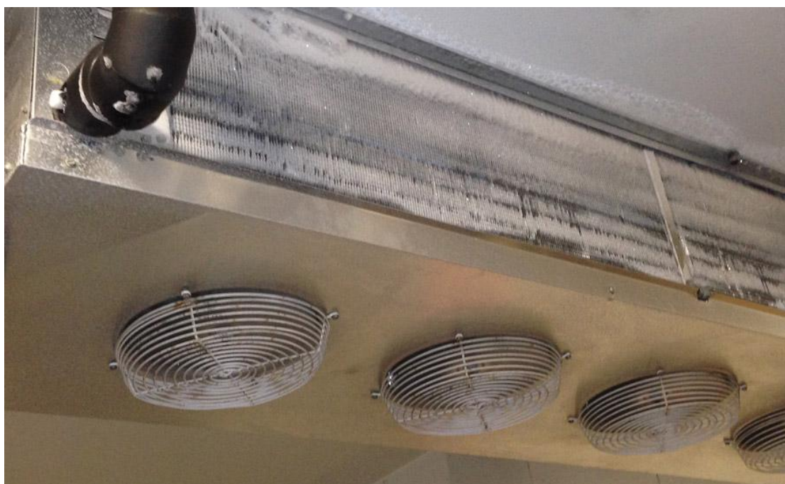
Εικόνα 52: Ατμοποιητής εξαναγκασμένης κυκλοφορίας που έχει υποστεί το φαινόμενο του παγοφραγμού
