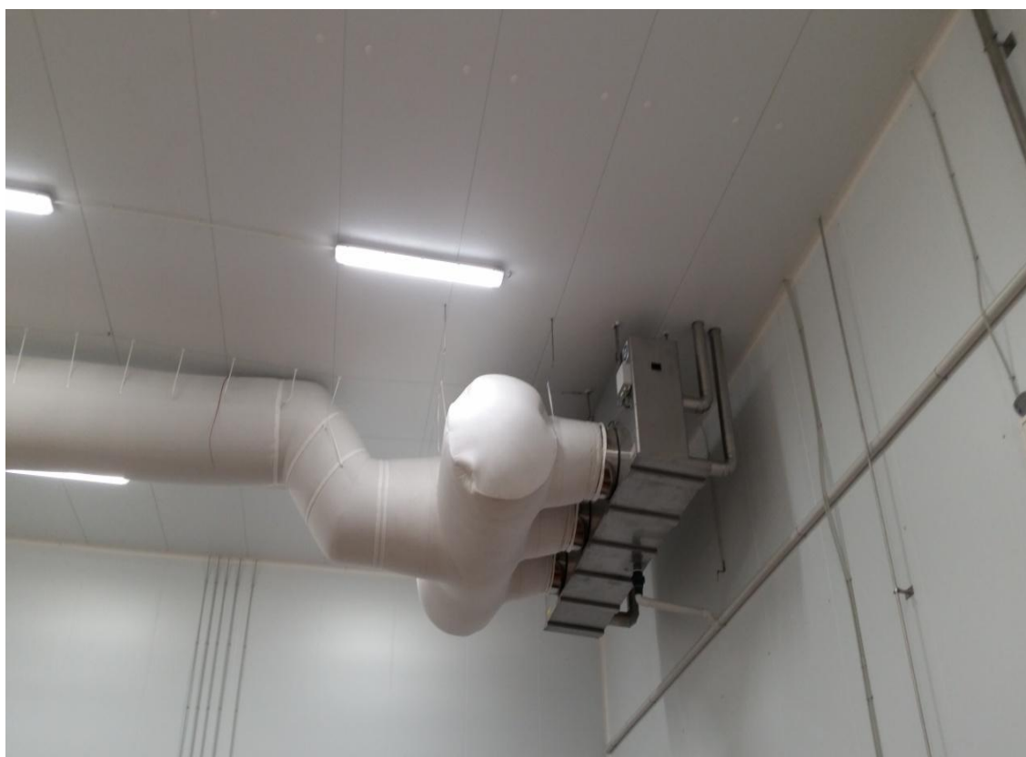
Εικόνα 50: Ψύκτης αέρα για τον κλιματισμό του χώρου εργασίας
