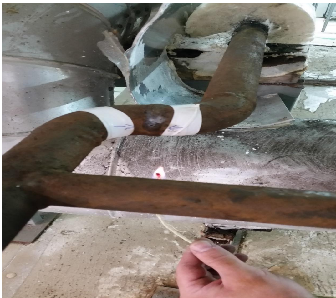
Εικόνα 54: Εντοπισμός σημείου διαρροής αμμωνίας ψυκτικής εγκατάστασης με την χρήση φλόγας θείου (χαρακτηριστικός είναι ο λευκός καπνός)
