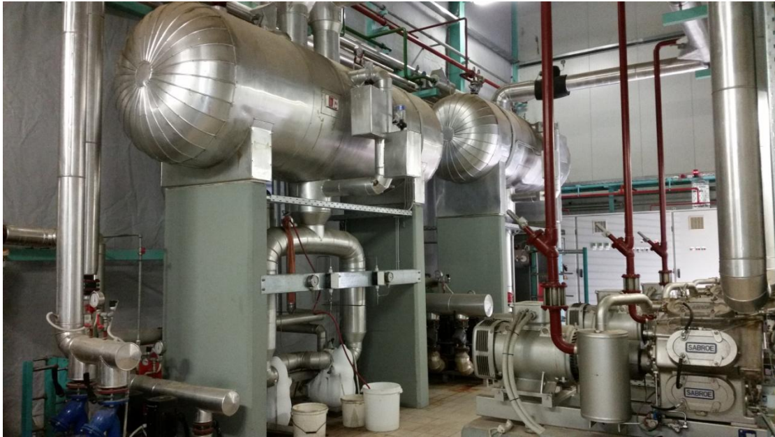
Εικόνα 43: Ψυχοστάσιο βιομηχανίας. Στην φωτογραφία απεικονίζεται μια ψυκτική εγκατάσταση με τρεις παλινδρομικούς συμπιεστές αμμωνίας και δυο συλλέκτες υγρού (αμμωνιοδιαχωριστές).
