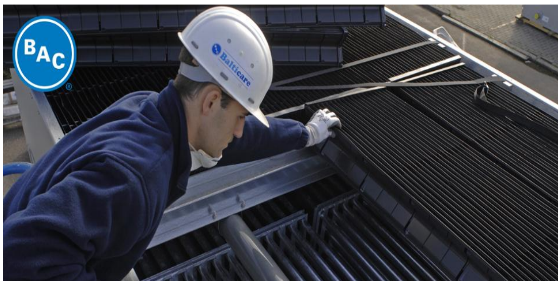
Εικόνα 39: Έλεγχος δικτύου σωληνώσεων και μπεκ ψεκασμού νερού
