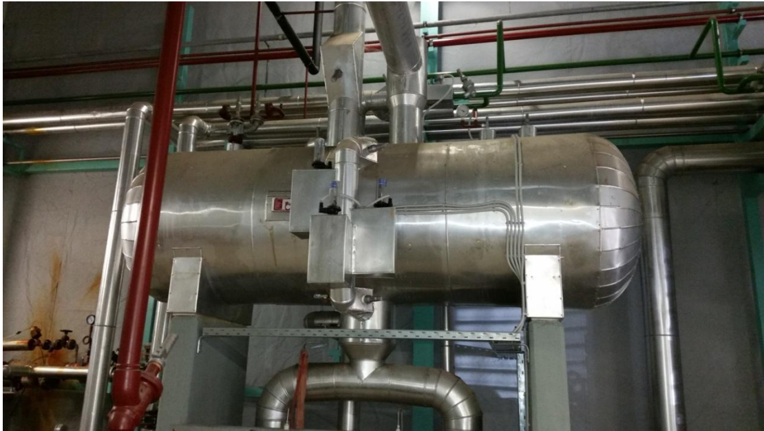
Εικόνα 42: Συλλέκτης υγρού σε ψυκτική εγκατάσταση αμμωνίας
