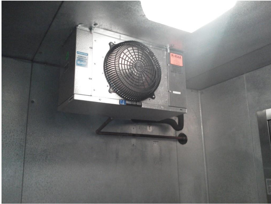
Εικόνα 46: Ατμοποιητής εξαναγκασμένης κυκλοφορίας τοποθετημένος στην οροφή του ψυκτικού θαλάμου
