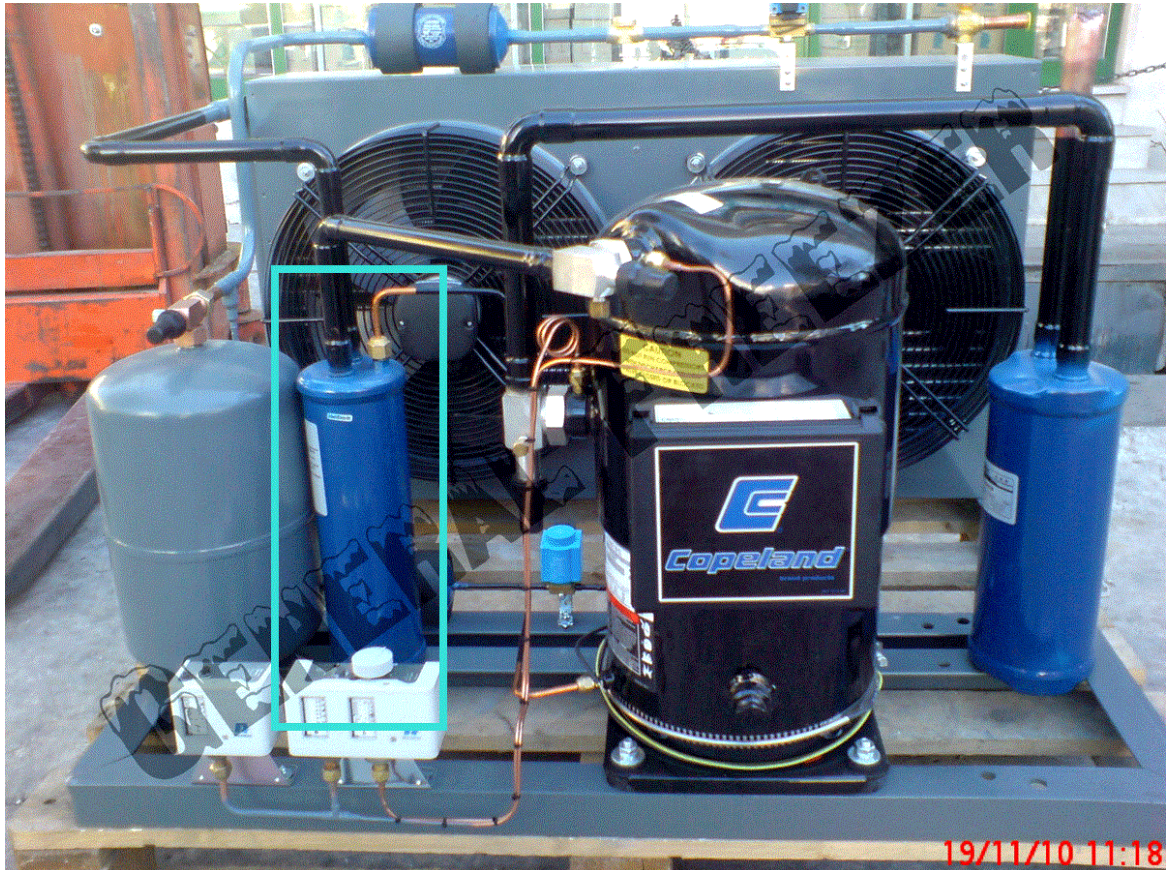
Εικόνα 30: Μονάδα συμπύκνωσης σπειροειδούς συμπιεστή. Μέσα στο πλαίσιο βρίσκεται ο ελαιοδιαχωριστής.
