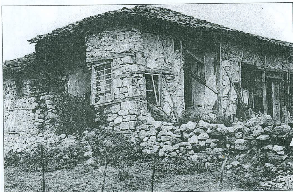
2. Έρειπωμένο άγροτικό σπίτι (Σιτοχώρι, 1963).
