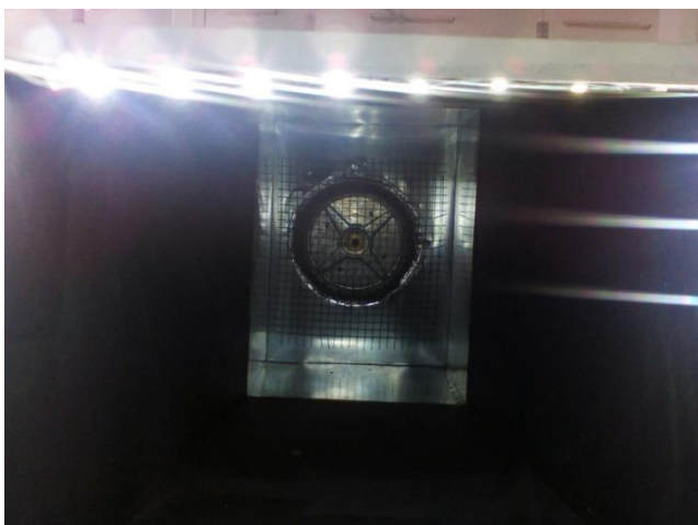
fig. 83 Εσωτερική όψη της αεροσήραγγας με τον φωτισμό και τον ανεμιστήρα.
