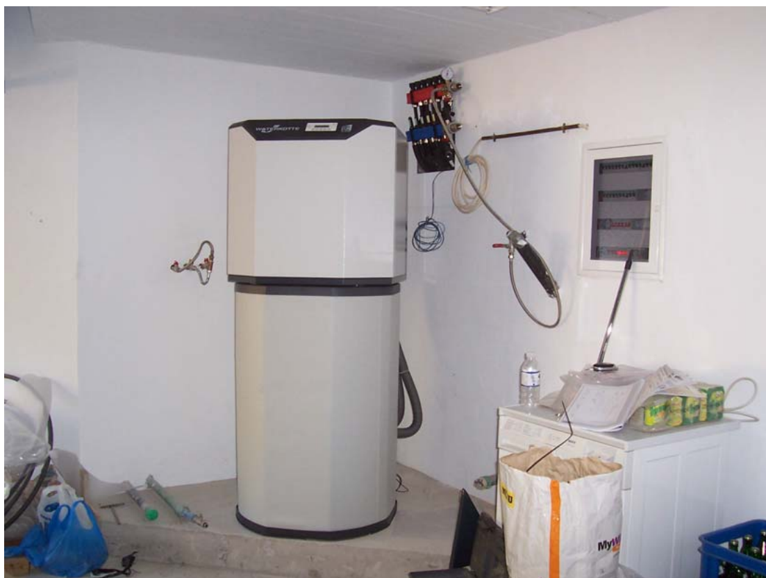
Σχήμα 8: Η αντλία θερμότητας που τοποθετήθηκε για την κάλυψη των αναγκών θέρμανσης και ψύξης αυτής της κατοικίας. Είναι χαρακτηριστικός ο μικρός όγκος που καταλαμβάνει
