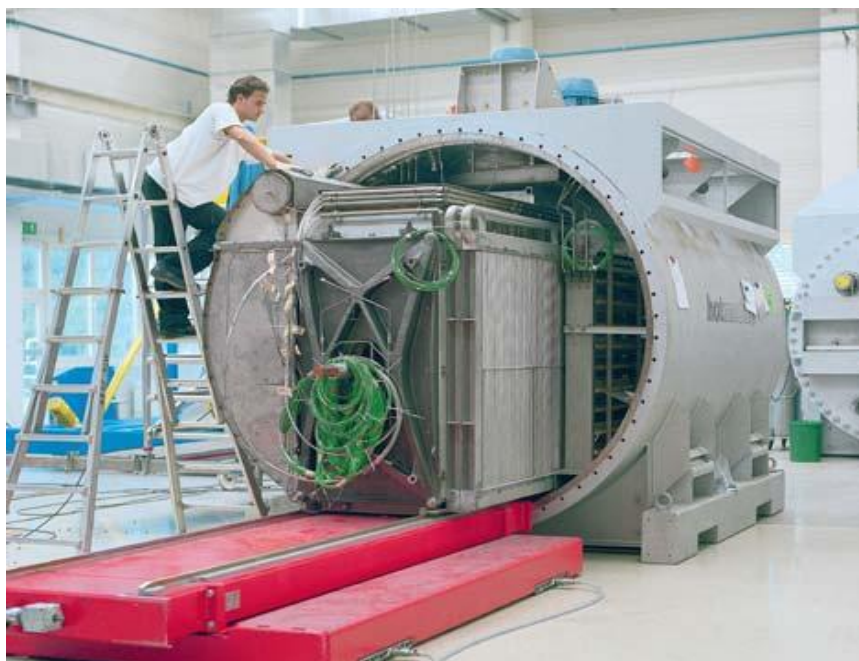
Εικόνα 6-8 Modern Molten Carbonate Fuel Cell in a T-Mobile data center in Munich
