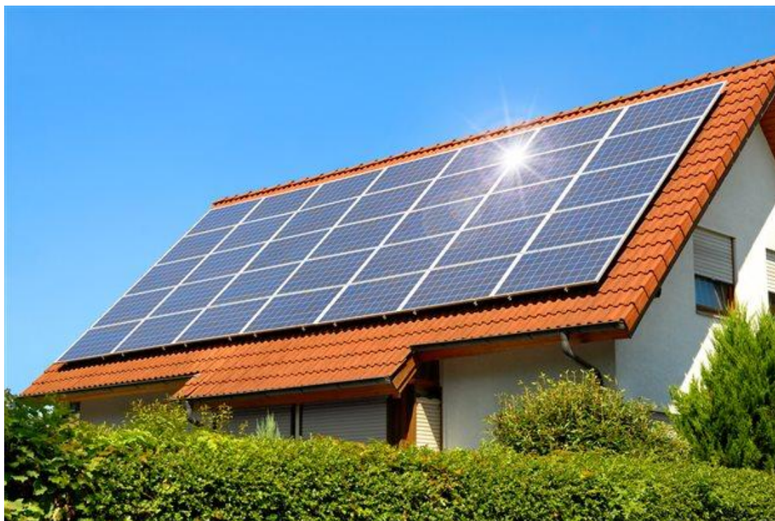
Εικόνα 2.8 - Φωτοβολταϊκά σε στέγη.
