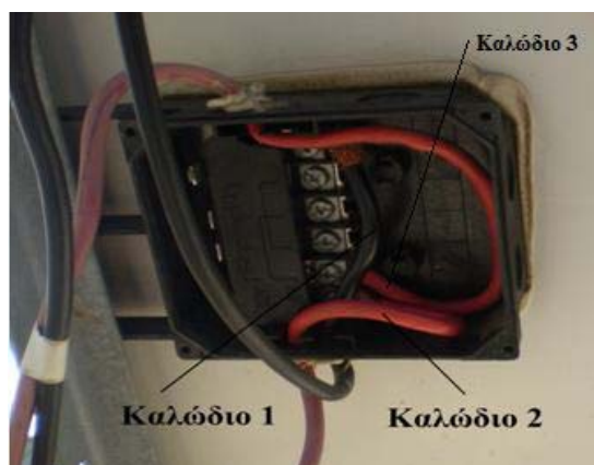
Σχήμα 4. 12: Κουτί διακλάδωσης του φωτοβολταϊκού πλαισίου 2
