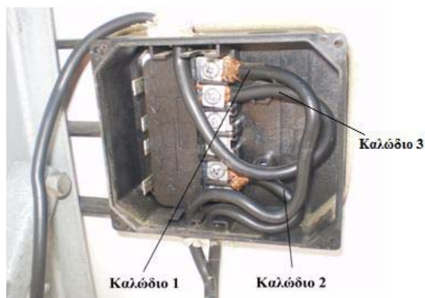
Σχήμα 4. 10: Κουτί διακλάδωσης του φωτοβολταϊκού πλαισίου 1
