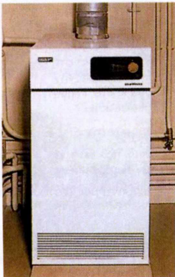
Λέβητας κεντρικής θέρμανσης Φυσικού Αερίου
