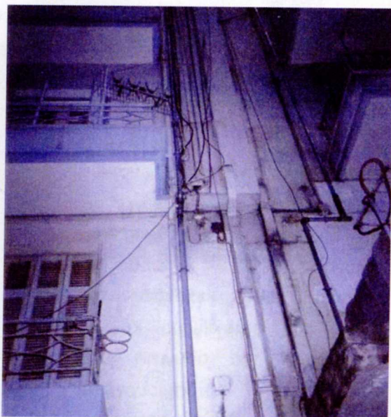
Σχήμα 14: Αγωγός πάνω σε καλώδια
