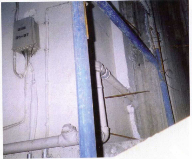
Σχήμα 16: Καλυμμένος αγωγός από μπετόν
